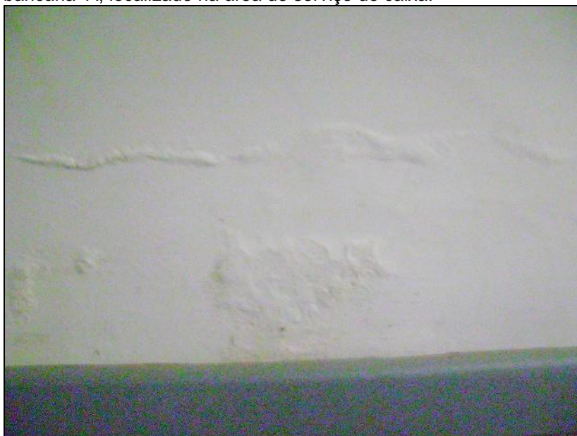
Figura 11 – Sinais de infiltração por capilaridade na agência bancária A, localizado na área de serviço de caixa.
