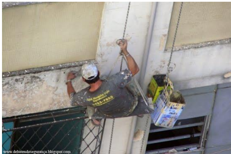
Figura 1: Ausência de EPI durante execução de atividade em altura.
