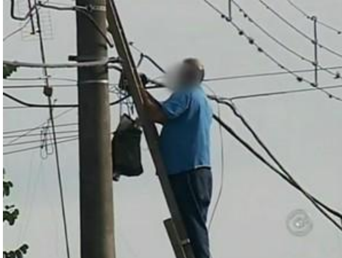
Figura 2: Trabalho em altura e com eletricidade sem EPI.
