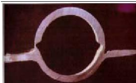
Figura 7 – Corrosão cáustica de tubos de caldeira
