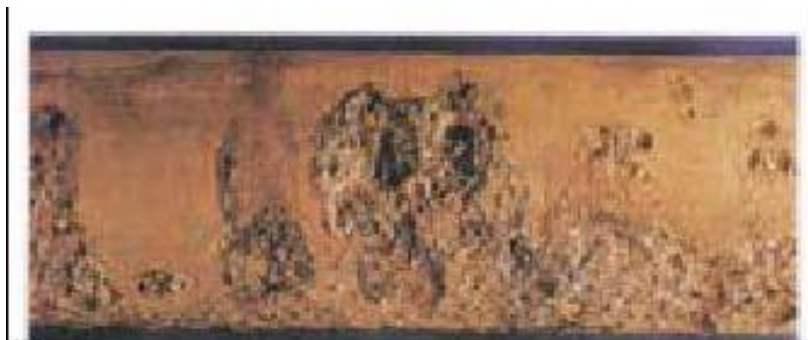
Figura 6 – Corrosão provocada por excesso de oxigênio na caldeira
