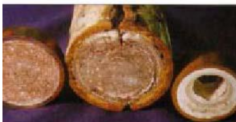
Figura 4 – Depósito no interior da tubulação de caldeiras
