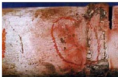
Figura 10 – Tubulação afetada por corrosão baixa fadiga
