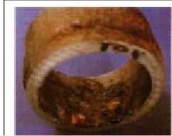
Figura 9 – Óxidos de ferro em área afetada por corrosão ácida
