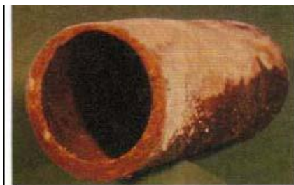
Figura 8 – Corrosão provocada pelos gases de combustão
