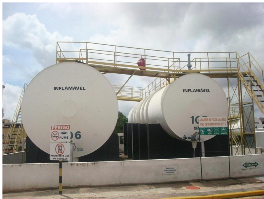
Figura 17: Tanques de armazenagem de JET A-1 e bacia de contenção
