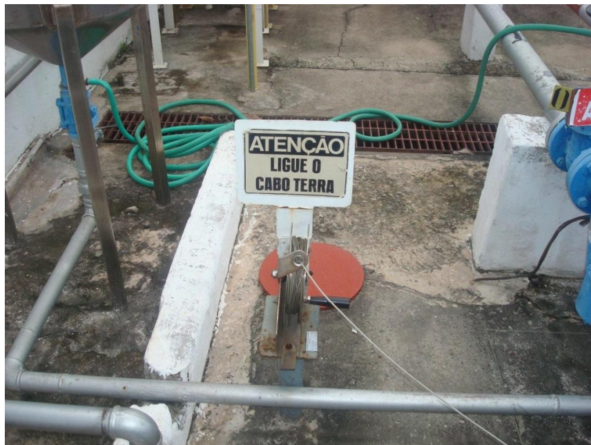
Figura 15: Ponto de aterramento - cabo terra
