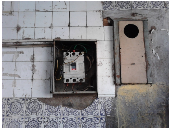
Caixa de energia sem proteção
