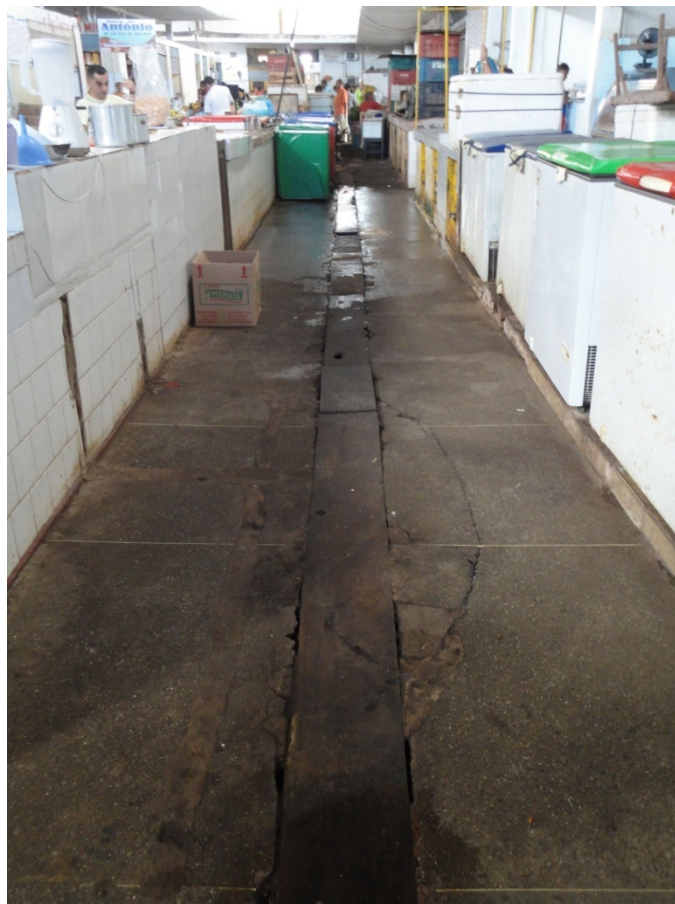
Piso danificado e sujo
