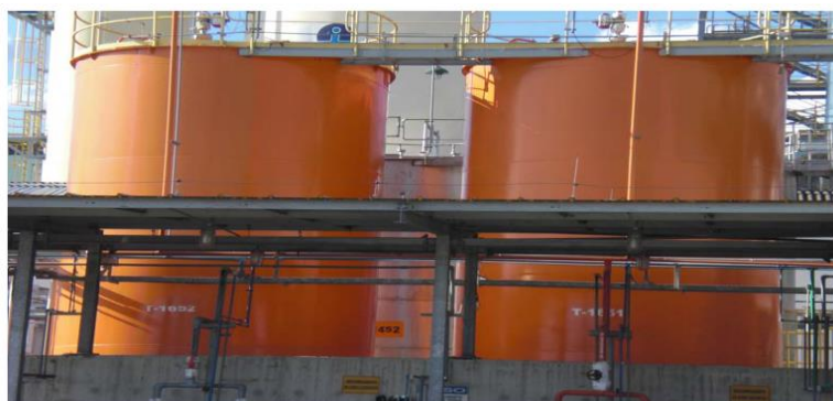
Figura 2 – Tanques de Ácido Sulfúrico
