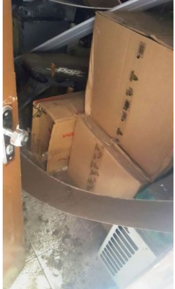
Figura 2 - Queda do forro de PVC no fórum de Tutóia/MA em maio/2016
