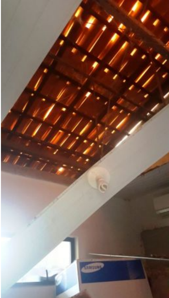
Figura 1 - Queda do forro de PVC no fórum de Tutóia/MA em maio/2016
