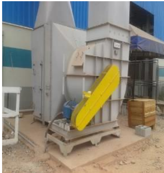
Figura 7 - Exaustor parte externa
