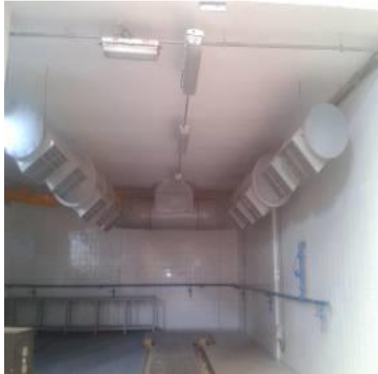
Figura 8 - Exaustor parte interna
