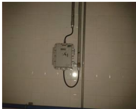
Figura 12 - Painel EX, a prova de explosão
