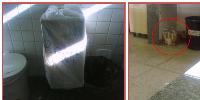
Figuras 1A e 1B: Recipientes de acondicionamento para perfurocortantes não conformes.
