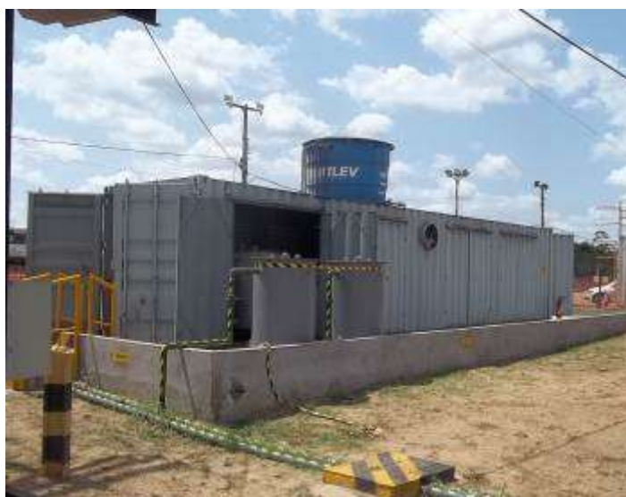
Figura 04 – Área externa do sistema de remediação. Fonte: Autor, 2013.
